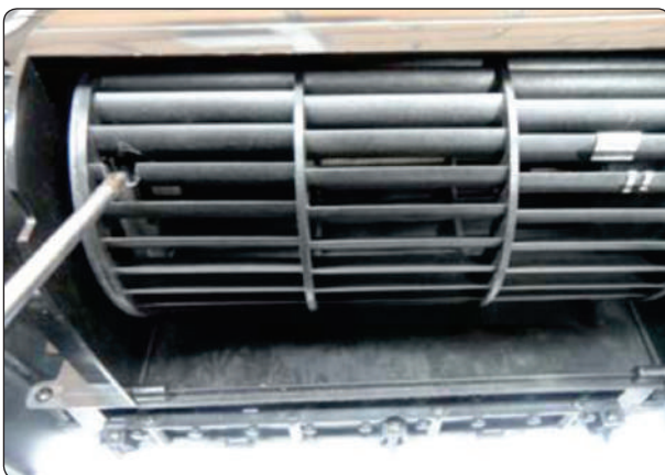
13.17 Retirando o Motor do Ventilador e Turbina
